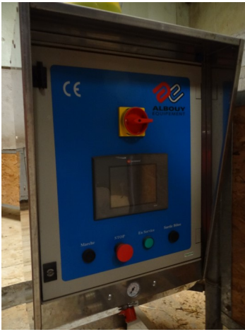
<- Boîtier du DAC et distribution en salle de traite (en bas à gch.)
