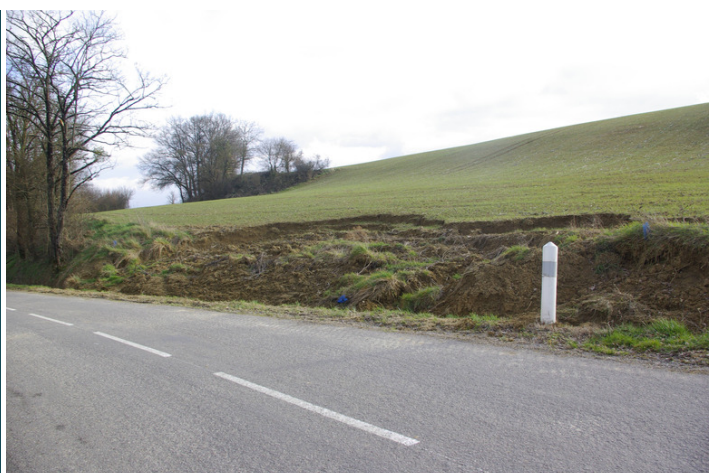
Effondrement de talus (Tarn)
